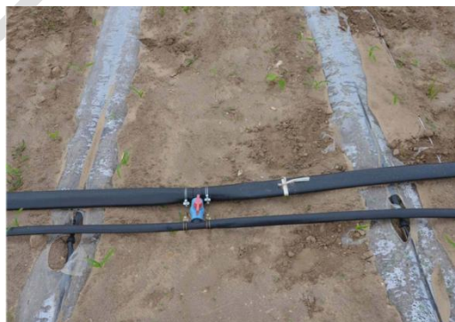
图 2 软管和滴灌带通过管件连接情况
